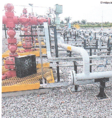
Estação de Gás Natural Gavião Branco, da Eneva, no Maranhão
